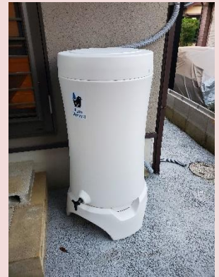
雨水を溜めるタンク
